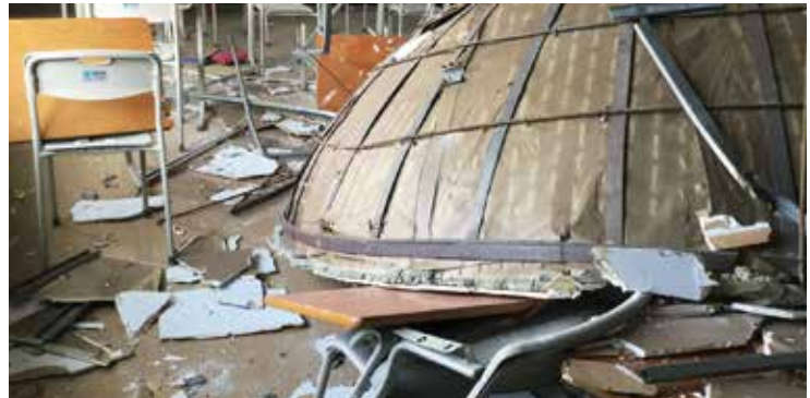
2号館「地学教室」も激しく損壊(落下したプラネタリウムドームが机を破壊)
