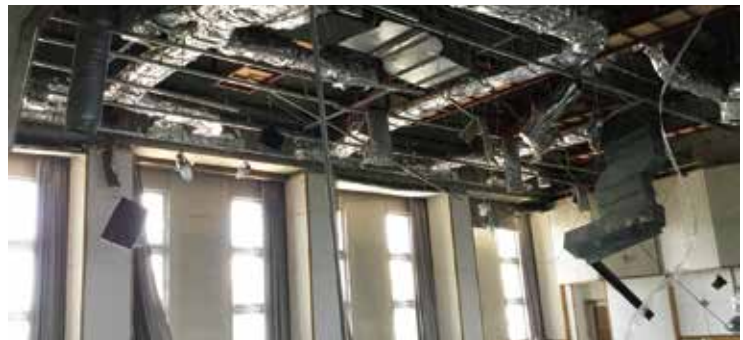
天井板が完全に崩落した3号館ホール(断熱材は散乱し、空調は宙ぶり状態に)
