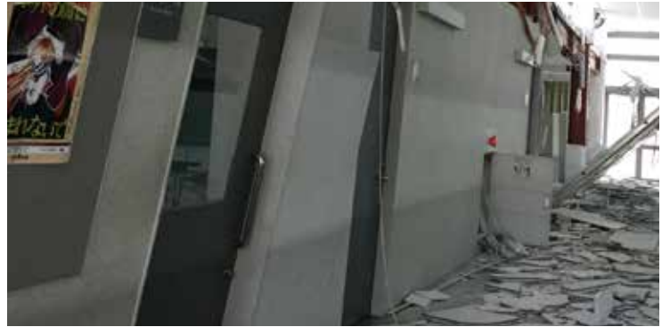
廊下と教室との壁が崩壊した4号館(被災校舎では最も危険な状態であった)
